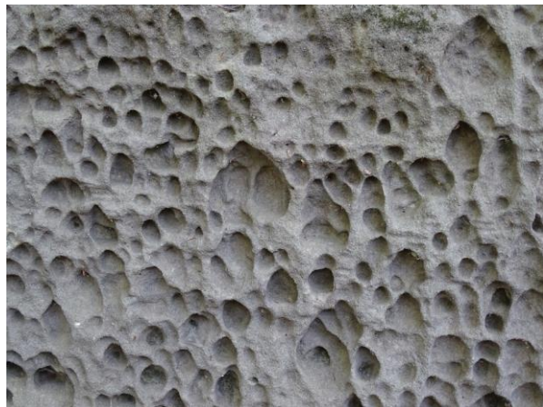
Obr. 5: Voštiny vzniklé solným zvětráváním zdobí povrch pískovcových skal
